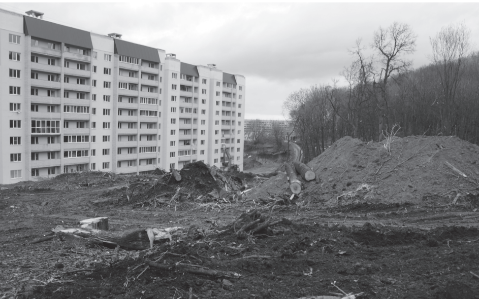
2013 год. Подготовка стройплощадки (без разрешения администрации МО «Город Саратов было вырублено 120 деревьев породы липа и дуб)
